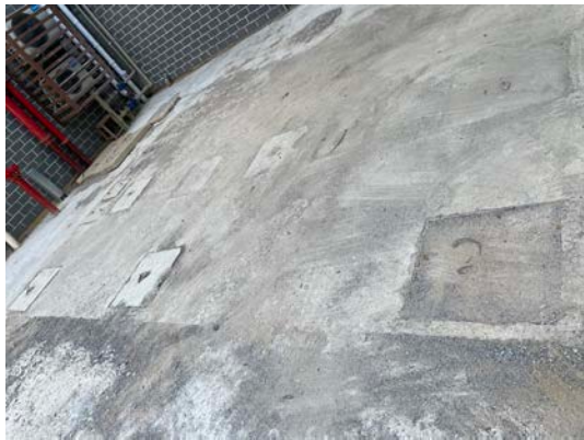
图 2-15 核医学科废水衰变池
