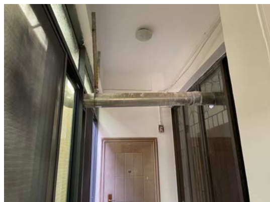
图 2-25 碘分装室外通道上方排风管道
