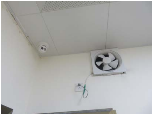
图 3-21 SPECT/CT 机房内摄像头及排风口
