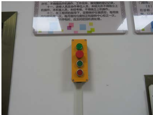
图 3-19 控制室内墙上急停按钮
