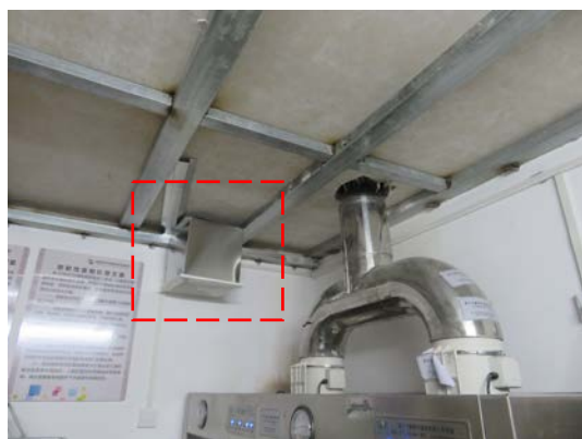
图 2-30 钼-钨分装柜室内排风口
