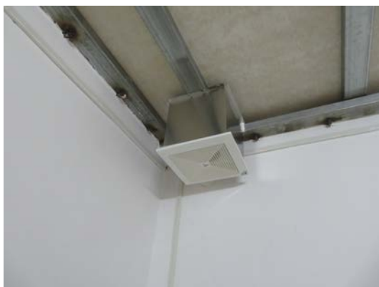
图 2-31 注射室内排风口
