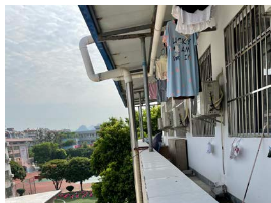
图 2-27 ^{131}\text{I} 专用通风柜排风管道口位于屋顶
