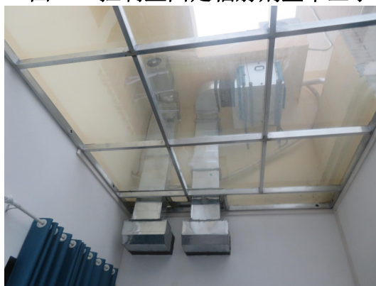
图 3-8 机房外进排风管道穿墙处
