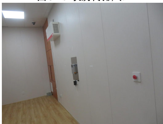
图 3-12 机房内紧急停机按钮
