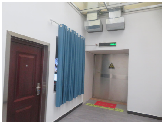
图 3-1 机房防护门外环境
