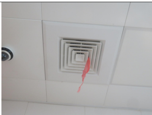
图 3-9 机房内进风口
