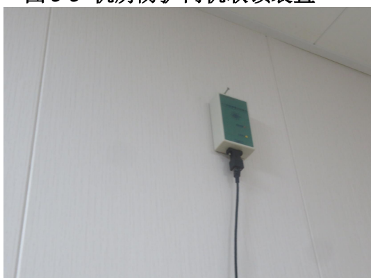
图 3-5 机房内固定辐射剂量率监测探头
