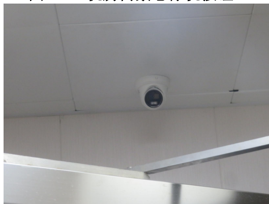
图 3-14 机房内视频摄像头
