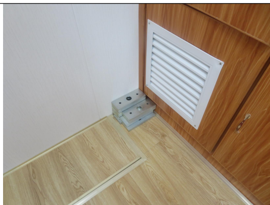
图 3-10 机房内排风口
