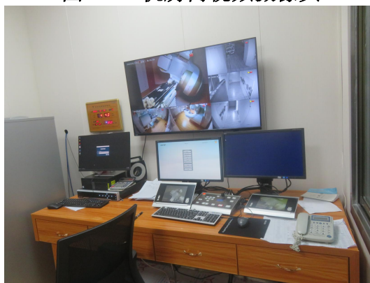
图 3-16 控制室控制台
