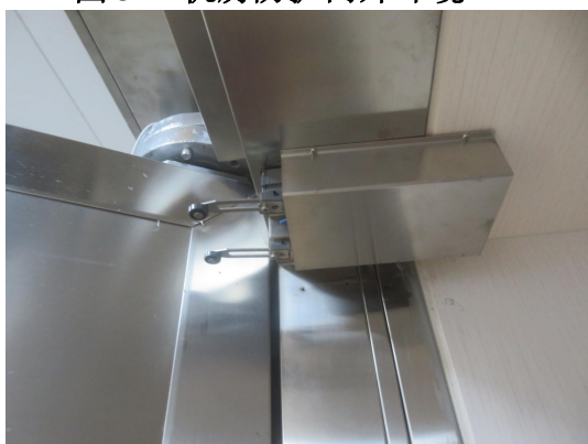
图 3-3 机房防护门机联锁装置
